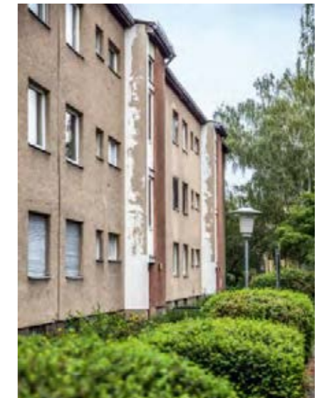
Sanierungsbedürftig: die Fassaden der Häuser im Greizer Viertel
