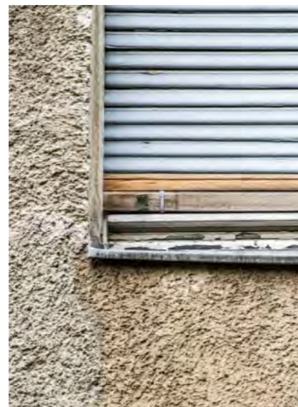
Blätteralarm: Die Jalousien und Rahmen der alten Fenster verlieren Farbe
